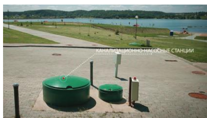
водопровод, 3 канализационные насосные станции, производительностью 24 куб.м/ч.
